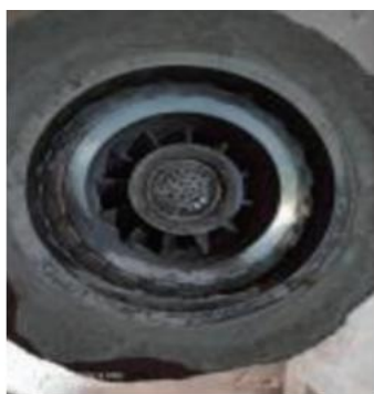
图 1 燃烧器更换前
